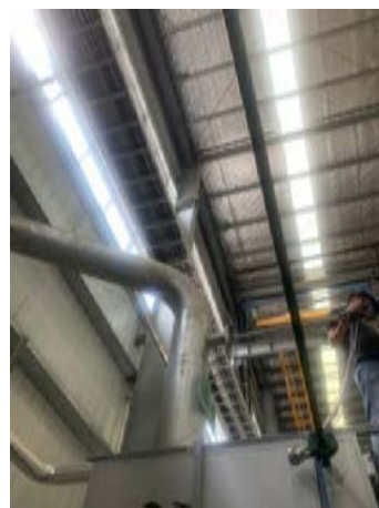
◎4 天然气锅炉排气筒
