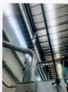
04 天然气锅炉排气筒
